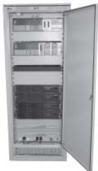
Базовая стойка одного из вычислительных устройств системы СКУД.
